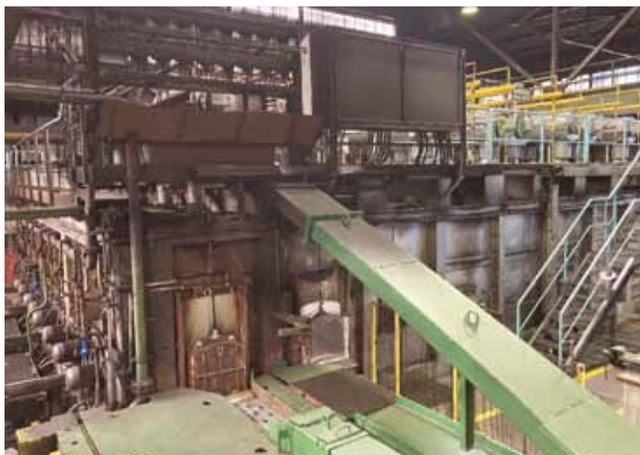
4-Zonen Hubbalkenofen mit einer Leistung von mehr als 10MW. Fotos: Deutsche Edelstahlwerke
