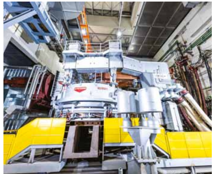
Der Elektrolichtbogenofen im neuen Edelstahlwerk wird zu 100 Prozent mit Strom aus erneuerbaren Energiequellen betrieben.
