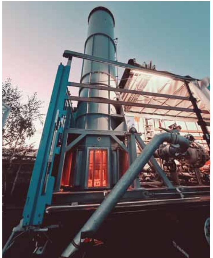
Die mobile Brennkammer ist auf einem Sattelaufleger installiert und mit allem ausgestattet, was für die Durchführung von Entgasung und Entlüftung benötigt wird. Fotos: ENDEGS
