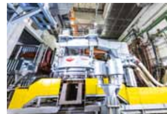
Der Elektrolichtbogenofen im neuen Edelstahlwerk wird zu 100 Prozent mit Strom aus erneuerbaren Energiequellen betrieben.
